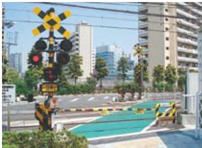
▲警報機・遮断機
