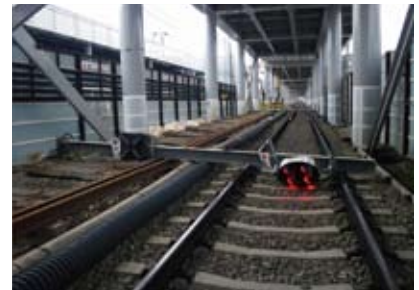
▲京急蒲田(空)第3踏切道発光信号機柱の倒壊
