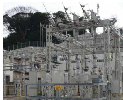
▲久里浜変電所 受電設備
