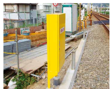
▲ 各駅や駅間に設置した非常脱出ハシゴ
