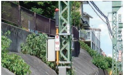
▲落石検知装置
