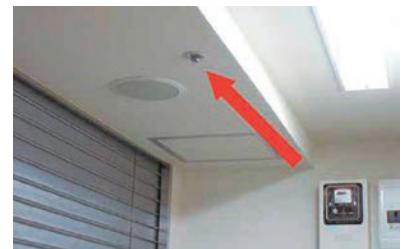
▲地下駅の火災対策「スプリンクラー」
