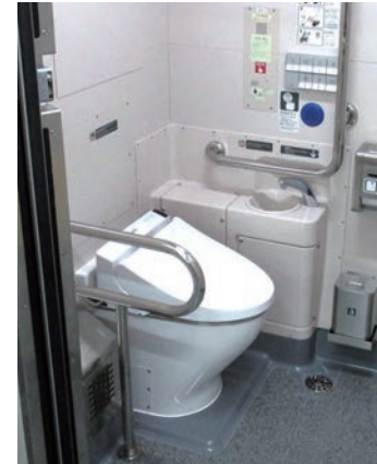
▲バリアフリー対応洋式トイレ(2号車)
